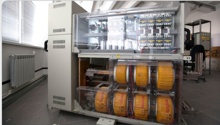
Трехфазный источник тока до 4400 А для испытаний на нагрев
