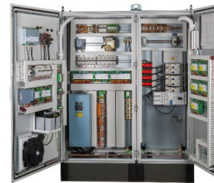
Шкафы автоматизации, пожаротушения и АСУТП
