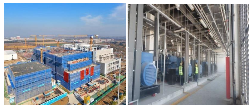
ЦОД Century Longteng, г. Вуху, 98*2000kW
