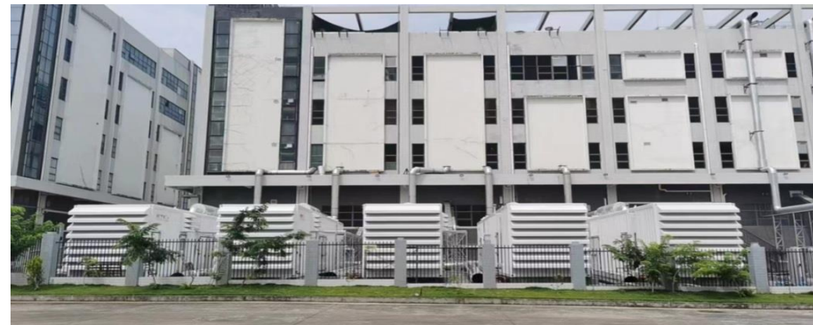
ЦОД IDC China Telecom, Шеньчжэнь 5*2200kW
