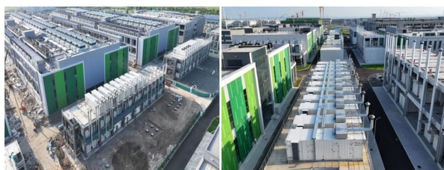
ЦОД Zhongjin в г. Уланчаб, 1-я очередь, 111*2000kW
