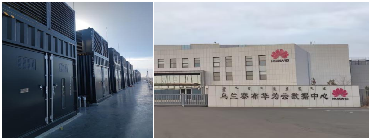
Уланбаа Data Center — высоковольтные контейнерные установки YC16VC мощностью 1800 кВт, всего поставлено 108 единиц.
