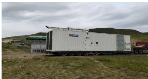
1: Повышенные требования к надежности в сложных эксплуатационных условиях.
