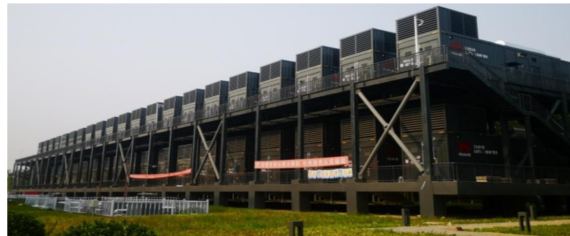
Ланфан (Langfang), Хэбэй — высоковольтные контейнерные установки YC16VC мощностью 1800 кВт, всего 43 единицы.
