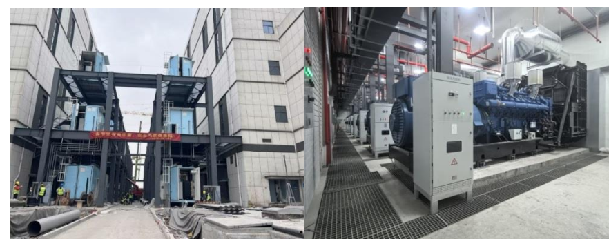
ЦОД Gangcheng Yunlian, 93 высоковольтные установки 2000kW (с 19 февраля по 25 мая непрерывная работа 2328 часов)
