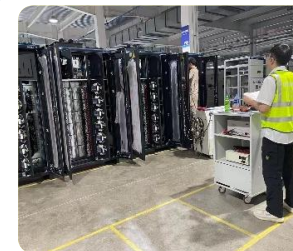
LV Switchgear & PDU FAT
